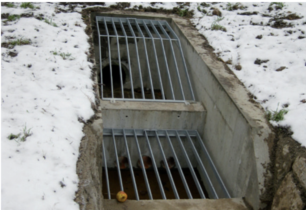
Abb. 32: Räumlicher Rechen am Einlauf zu einer Verrohrung
